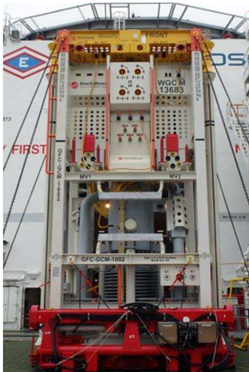
Рисунок 6. Компрессор WGC 4000, установленный на месторождении Gulfaks, Норвегия
